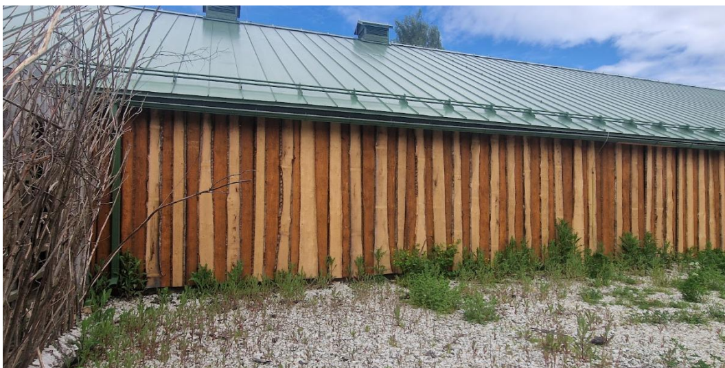
Foto 3. Hoone fassaad servamata lauast. Turvaala puhul tuleks arvestada ka tugeva sadevee ja lume langemisega katusest.
